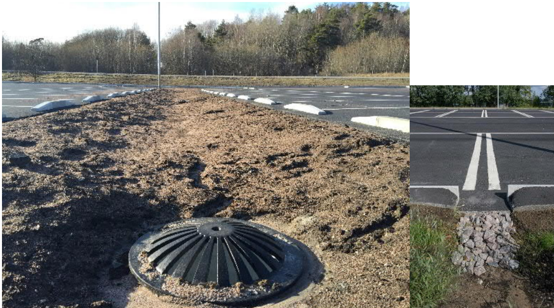
Figur 17. Exempel på nyanlagd översilningsyta från parkering. Foto: Per Norberg och Peter Svensson (smhi.se)
