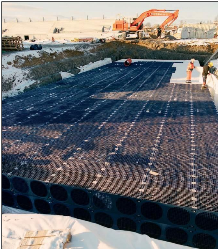
Figur 13. Exempel på utjämningsmagasin i form av dagvattenkassetter (Wavin)
