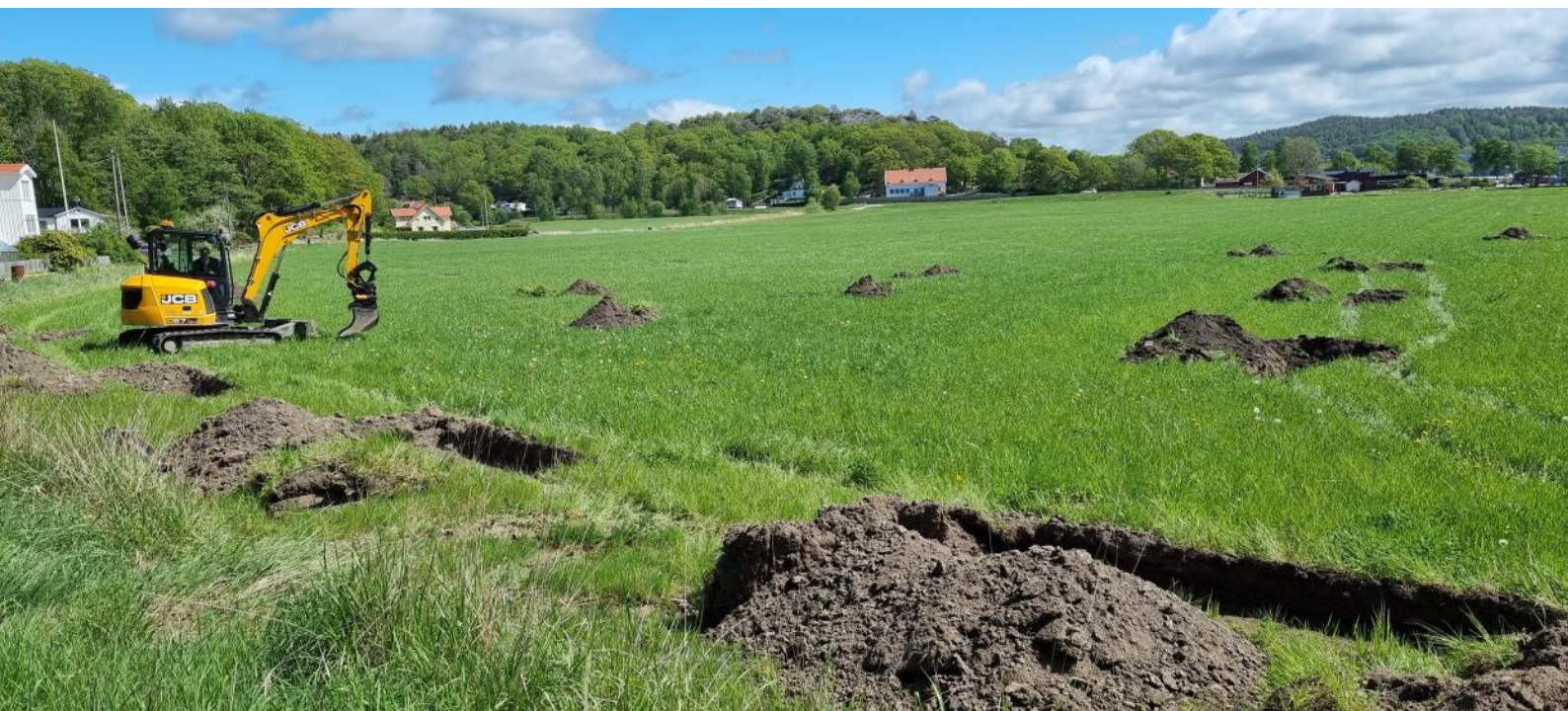
Figur 2. Foto från sydväst som visar några av de grävda schakten. Foto av Mats Hellgren.
