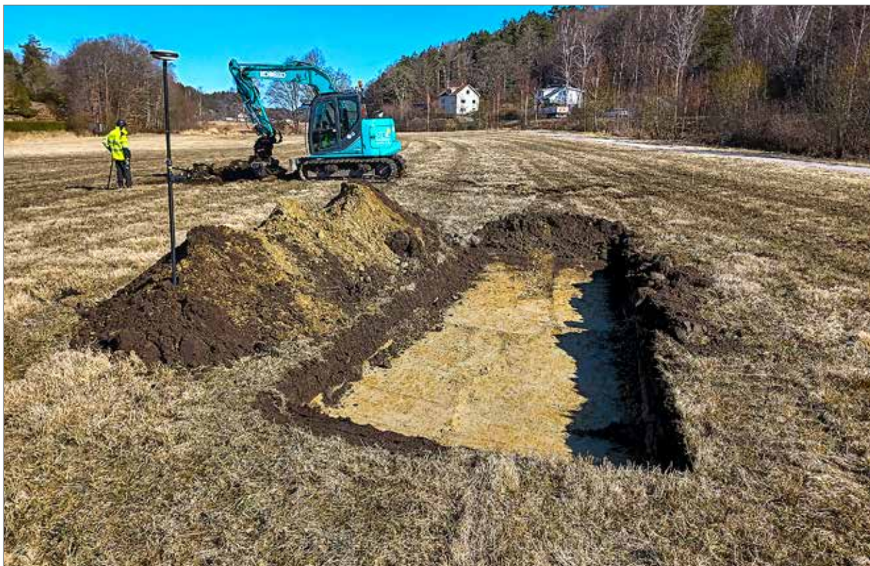
Figur 6. Arbetsbild samt översikt över schakt 53. Foto från syd av Mattias Frisk, Bohusläns museum.
