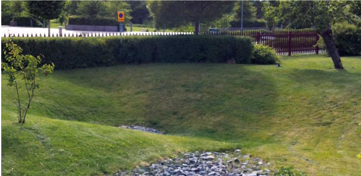
Figur 38 Svackdike, bild från stockholmvattnochavfall.se
