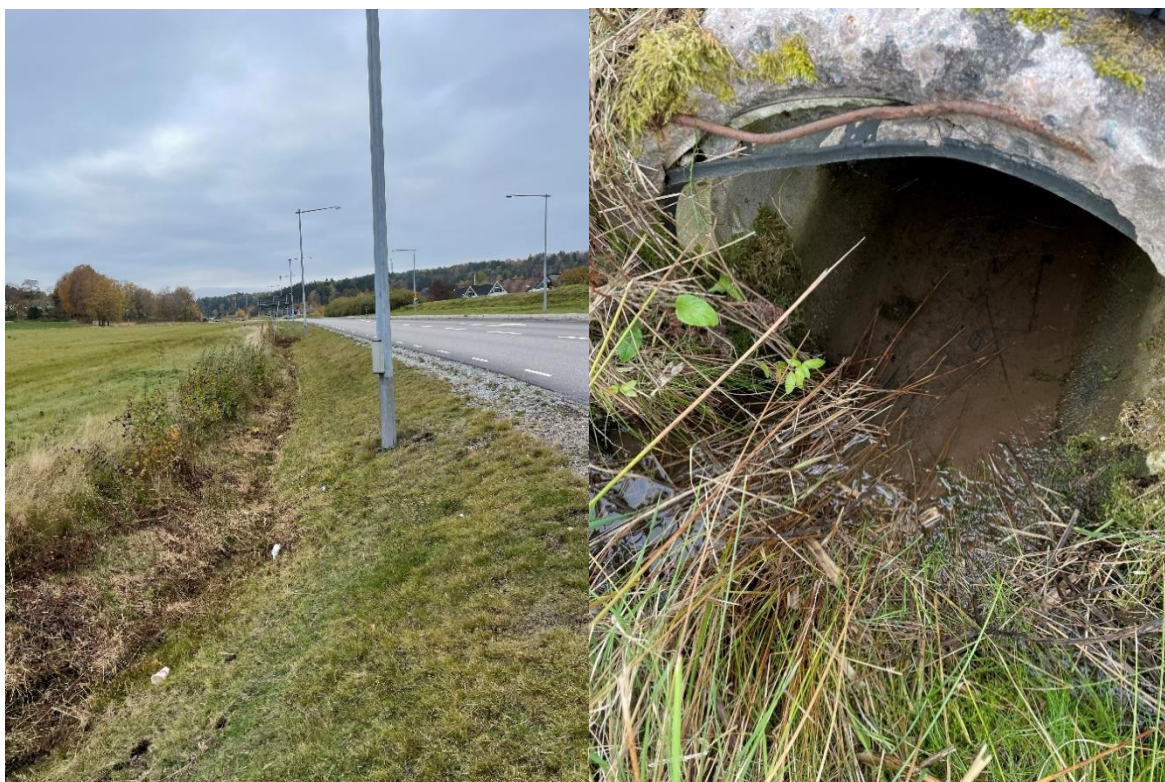
Figur 11. Diket längst med Ucklumsvägen (vänster), trumman under Hallarnaleden (höger).
